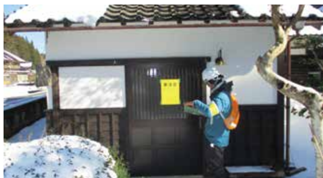
▲建物の被害状況から、二次災害発生の危険度を判定し、表示
