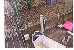
50. 店舗北側水道
