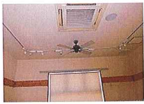
36. エアコン(客室A)
