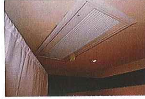
42. エアコン(客室D-3)
