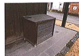
室外機(長屋門西)
