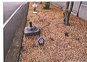
店舗回り照明(西側)
