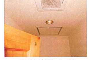
照明(男子トイレ内)
