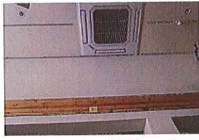
37. エアコン(客室C-1)
