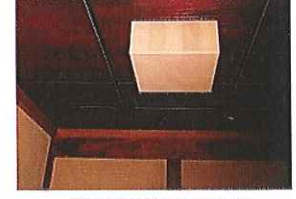
長屋門照明(西2)
