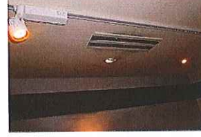
43. エアコン(客室D-4)
