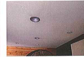
照明(エントランス)
