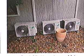
室外機(レストラン棟)
