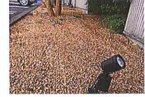
店舗回り照明(北側)
