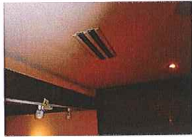
41. エアコン(客室D-2)
