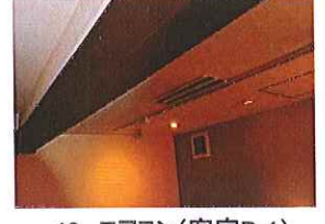
40. エアコン(客室D-1)
