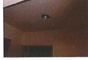
照明(男子トイレ前)
