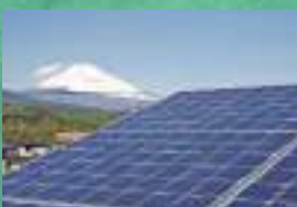
▲裾野市庁舎の太陽光パネル
