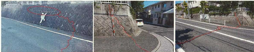
①擁壁から路面に至る連続したクラック
